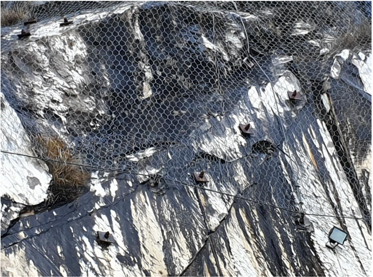
Reti in aderenza e chiodature esistenti lungo le discontinuità critiche.
